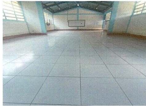
Foto 2: Finalización de colocación de piso cerámico en el aula de tercero y sexto primaria.
