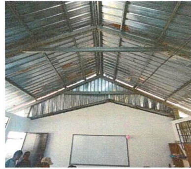
Foto 4: Finalización de instalación de láminas laterales en el techo del aula nueva.
